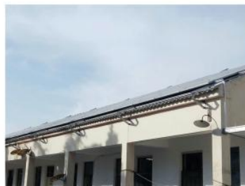
谷亭街道东段村光伏发电
